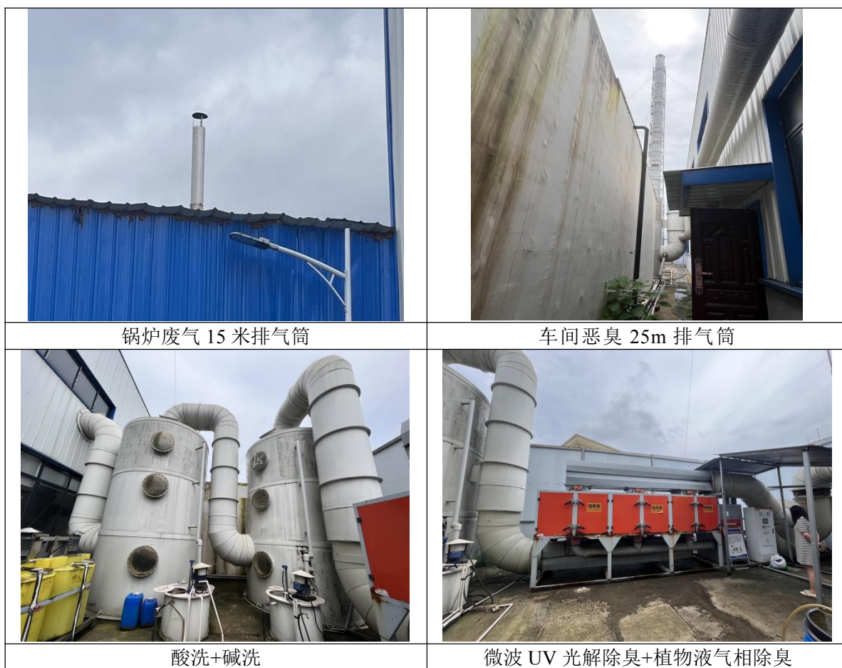
图 2-7 废气处理设施现状图
