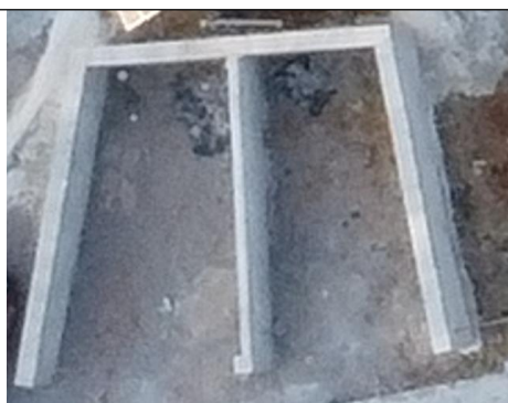
跃进水库未拆除临时工程
