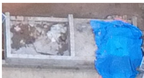
富田冲水库未拆除临时工程及遗留建筑材料
