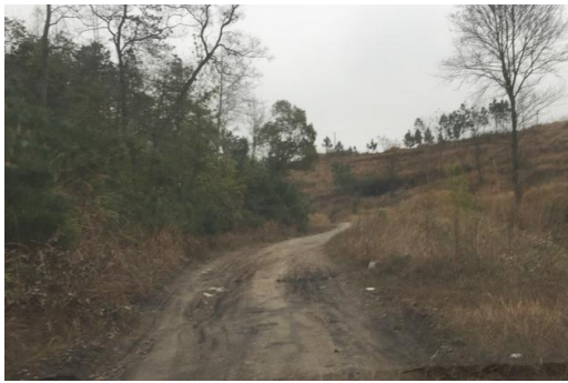
村道、部分路面破损严重
