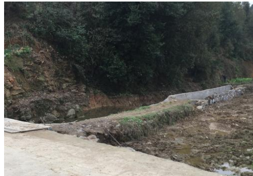
排水防护缺失
